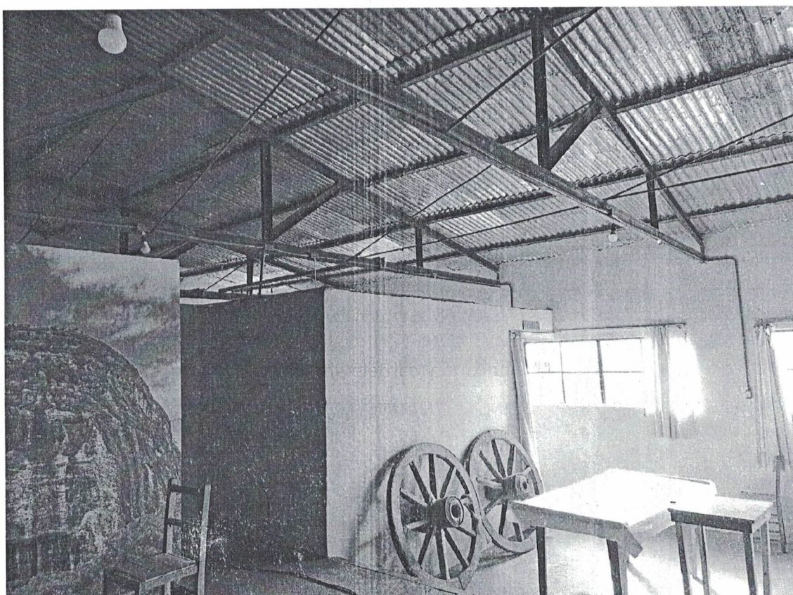
Foto 2: Instalações elétricas, feitas por conduteles, na parte de cima das vigas de ferro da entidade.
