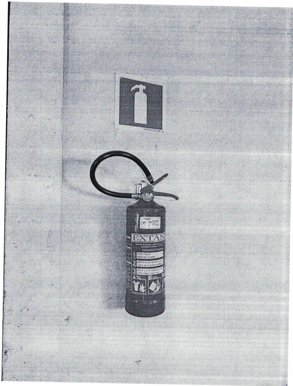
Foto 1 : Extintor ABC instalado na Ronda do CTG.
